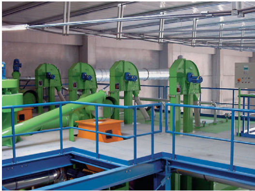
Gurtbecherwerke und Röhrförderschnecke für Reifen-Recyclinganlage
