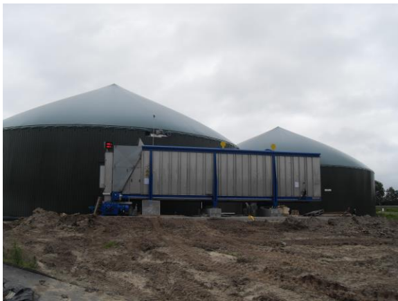
Feststoffdosierer 60m³ mit Pressschnecke
