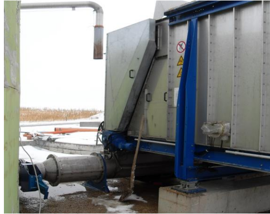
Feststoffdosierer mit Pressschnecke
