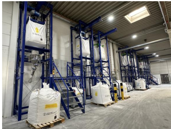
Drei Big Bag-Entleerstationen mit Brandwanddurchgang und Dosier-Förderschnecke
