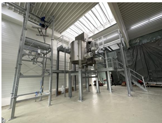
Mischergestell mit Bedienbühne in zwei Ebenen sowie einer Big Bag-Entleerstation mit Produktzuführung und einer Hand-Sackaufgabe mit Palettenstellplatz
