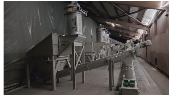
Zwei 3-fach-Big Bag Entleerstationen mit Elektrokettzügen und Aufgabetrichern sowie einer großflächigen Bedienbühne
