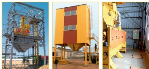
Etappen der Installation und Inbetriebnahme des ZAV-Niva-25
