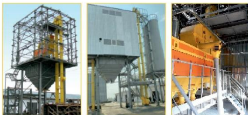
Etappen der Installation und Inbetriebnahme des ZAV-Niva-50
